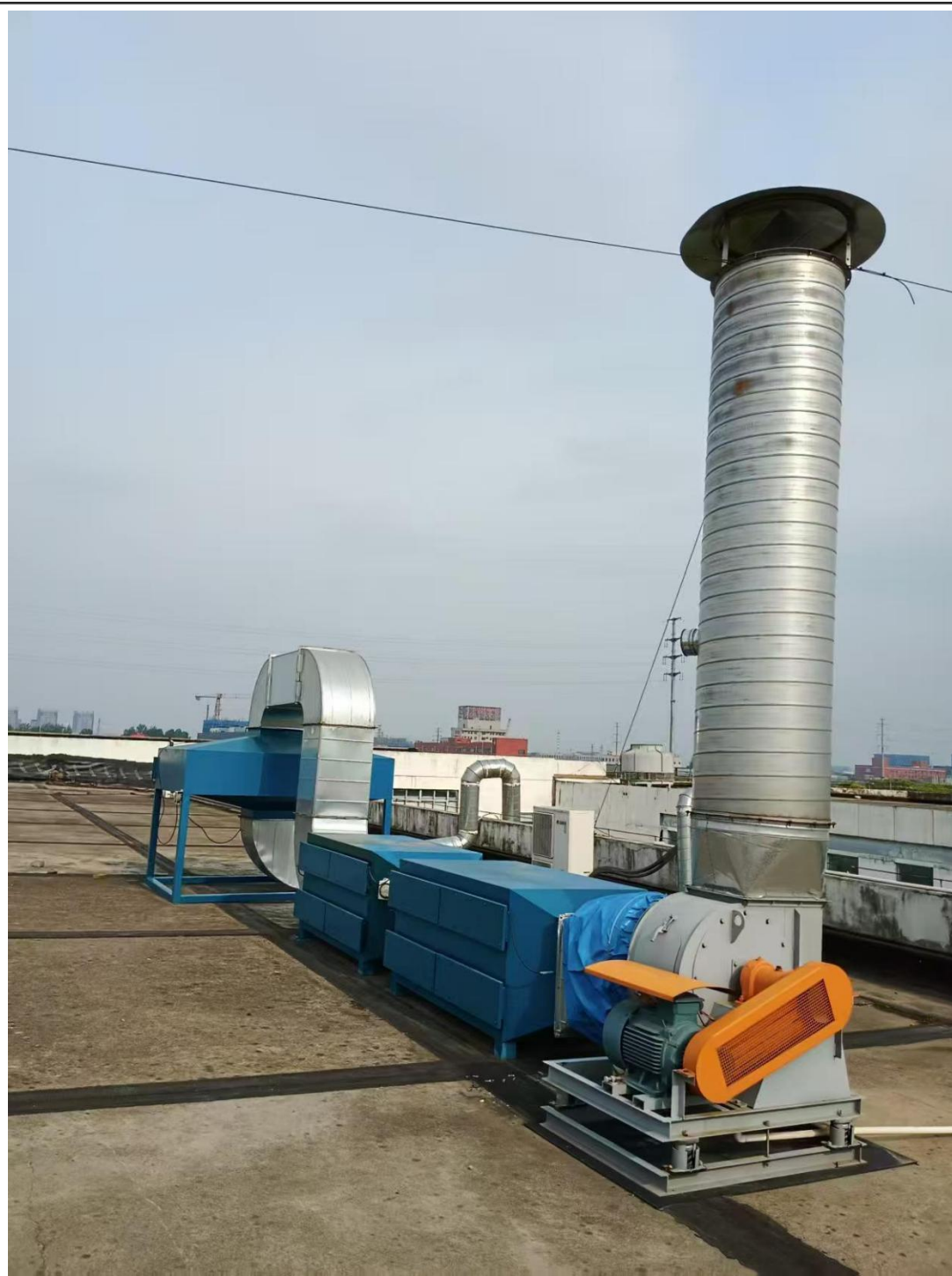
废气处理设施
